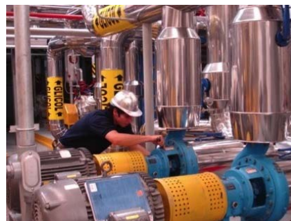
Foto 8 Verificación del estado del aislamiento de las tuberías y accesorios de un sistema de enfriamiento.
