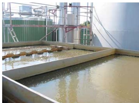
Foto 5 Agua tratada en un reactor UASB (anaeróbico) en una planta de jugos de frutas
